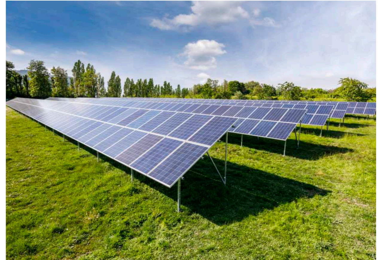
PV Anlagen auf Grünland. Traiskirchen © Wien Energie
