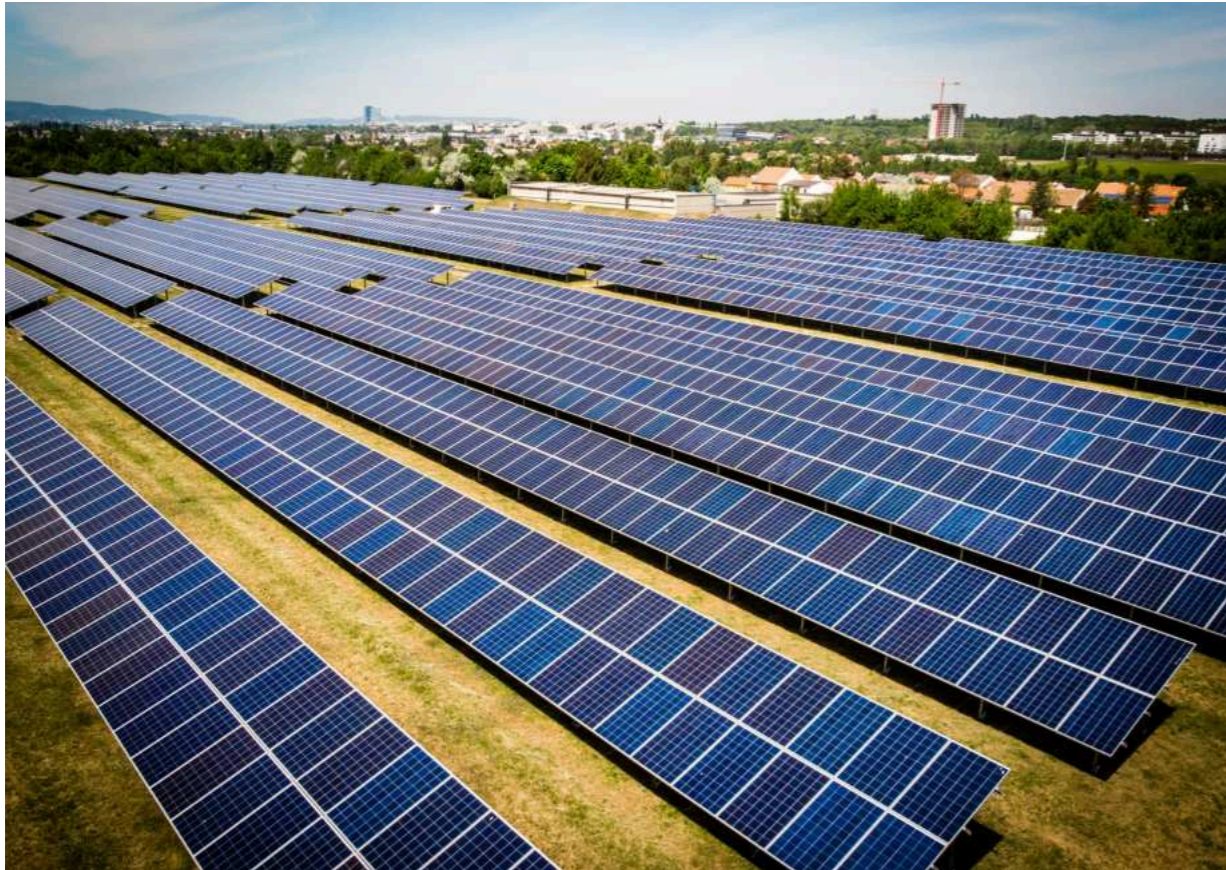
PV Anlagen Wasserbehälter. Unterlaa © MA31 Fürthner
