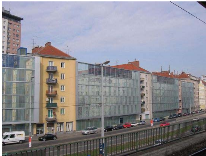
Abbildung 9: Lärmschutzwand in Wien, 18 m hohe Lärmschutzwand mit integrierter Photovoltaik, Module: 54 Verbundsicherheitsglas-Module (1.230 x 2.904 mm), Installierte Fläche: 188 m 2 , Installierte Leistung: 15,4 kWp 19
