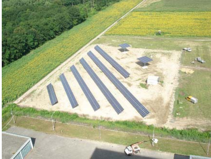
Abbildung 18: Photovoltaik-Anlage Zwentendorf, NÖ, 180 kWp, Aufdachanlage, Fassadenanlage und Freiflächen-Solarpark. Auf Freiflächenanlage gibt es neben fix aufgeständerten Solargeneratoren, auch der Sonne nachgeführte Solarsysteme. Das Gelände des Atomkraftwerkes ist nach wie vor ein zugelassener Kraftwerksstandort, daher mussten keine aufwändigen Bewilligungen mehr eingeholt werden. Auch die bereits vorhandene Infrastruktur ist von Vorteil, denn in Zwentendorf sind bereits wichtige Anlagenteile vorhanden, um Energie ins Stromnetz einzuspeisen. 28
