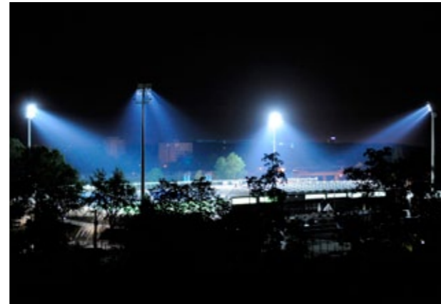
Im Bild sind Strahler des FSV-Stadions in Frankfurt mit Metallhalogenid-Hochdrucklampen zu sehen. Die ursprünglich stark vorhandene Streustrahlung in die Umgebung konnte mit Ausblendrastern deutlich reduziert werden. Die Sichtbarkeit auf weite Distanz ist dennoch gegeben.
